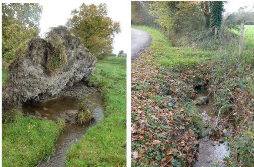
Figure 19 : situations dégradées - Source : SMGBO
