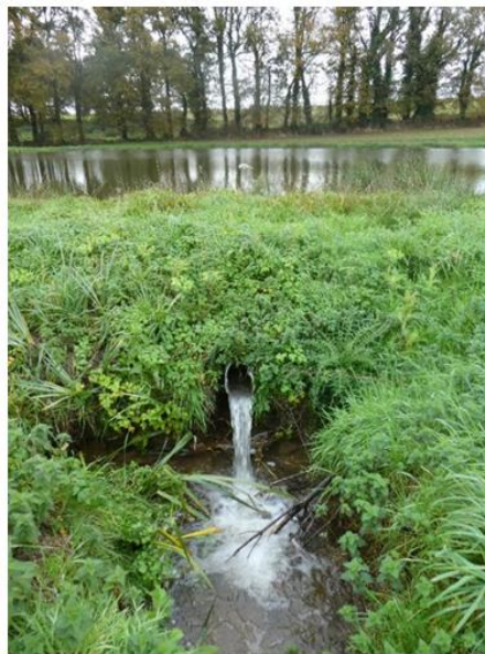
Figure 15 : Situation dégradée – Source : SMGBO
