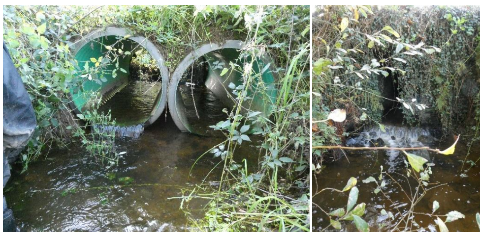
Figure 76: Situations dégradées – Source : SMGBO
